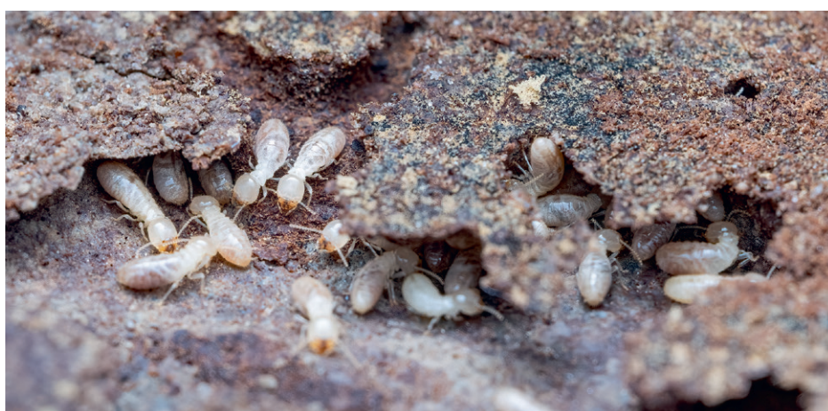
2. Reticulitermes flavipes op de Nederlandse locatie, in gangen in (a) een dode droge boomstam in een plantenkas en (b) in een plaat van geperst hout onder vloerbedekking. Foto's: Jitte Groothuis 2. Reticulitermes flavipes on the location in the Netherlands, in holes in (a) a dry dead tree trunk in a plant glasshouse and (b) in a plate of pressed wood under carpeting.
